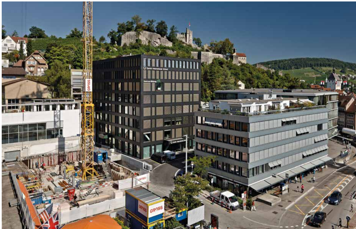
Der im Bau befindliche Gebäudekomplex West in direkter Nachbarschaft zum Lindenplatz Ost. Im Hintergrund Burg und Altstadt von Baden.
